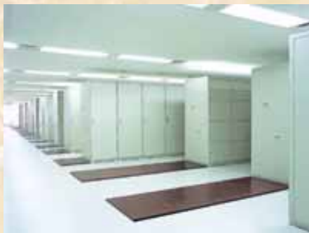
データセンター 上記写真はイメージです。
